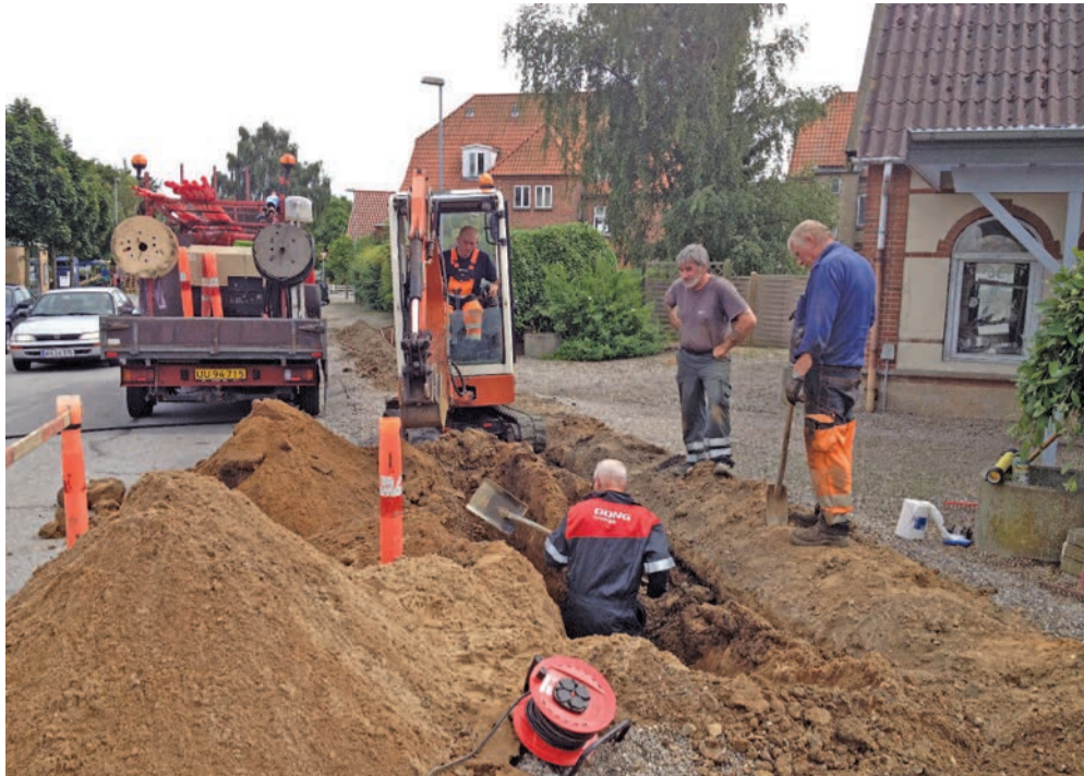
Det var ud for Ejsbølvej 2, gravemaskinen ramte et gaskabel og dermed lige over for Ejsbøl-centret med både børnehave og ældreboliger.
